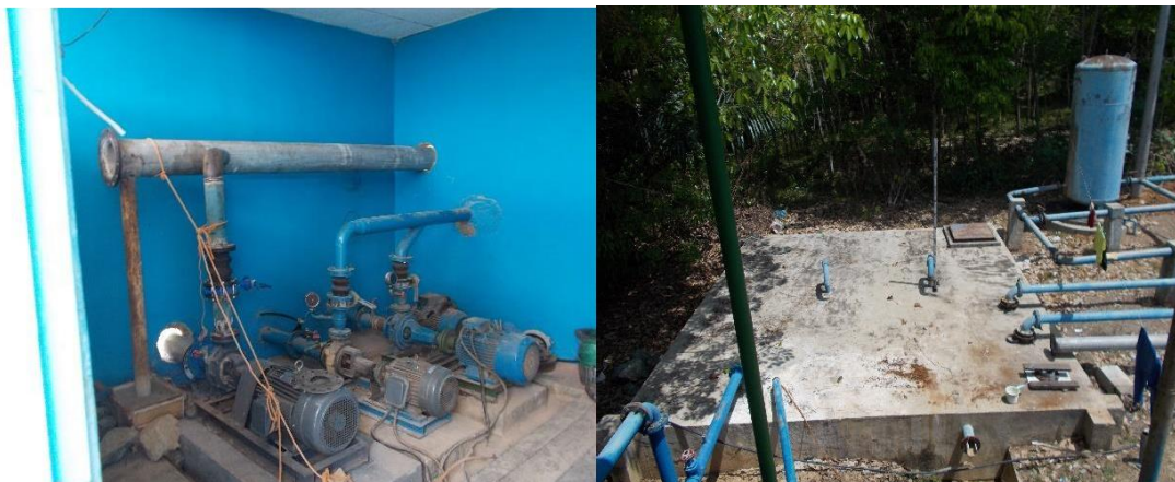
Gambar 3.29 Pompa distribusi dan Reservoar di IPA Cabang III Pengaron
